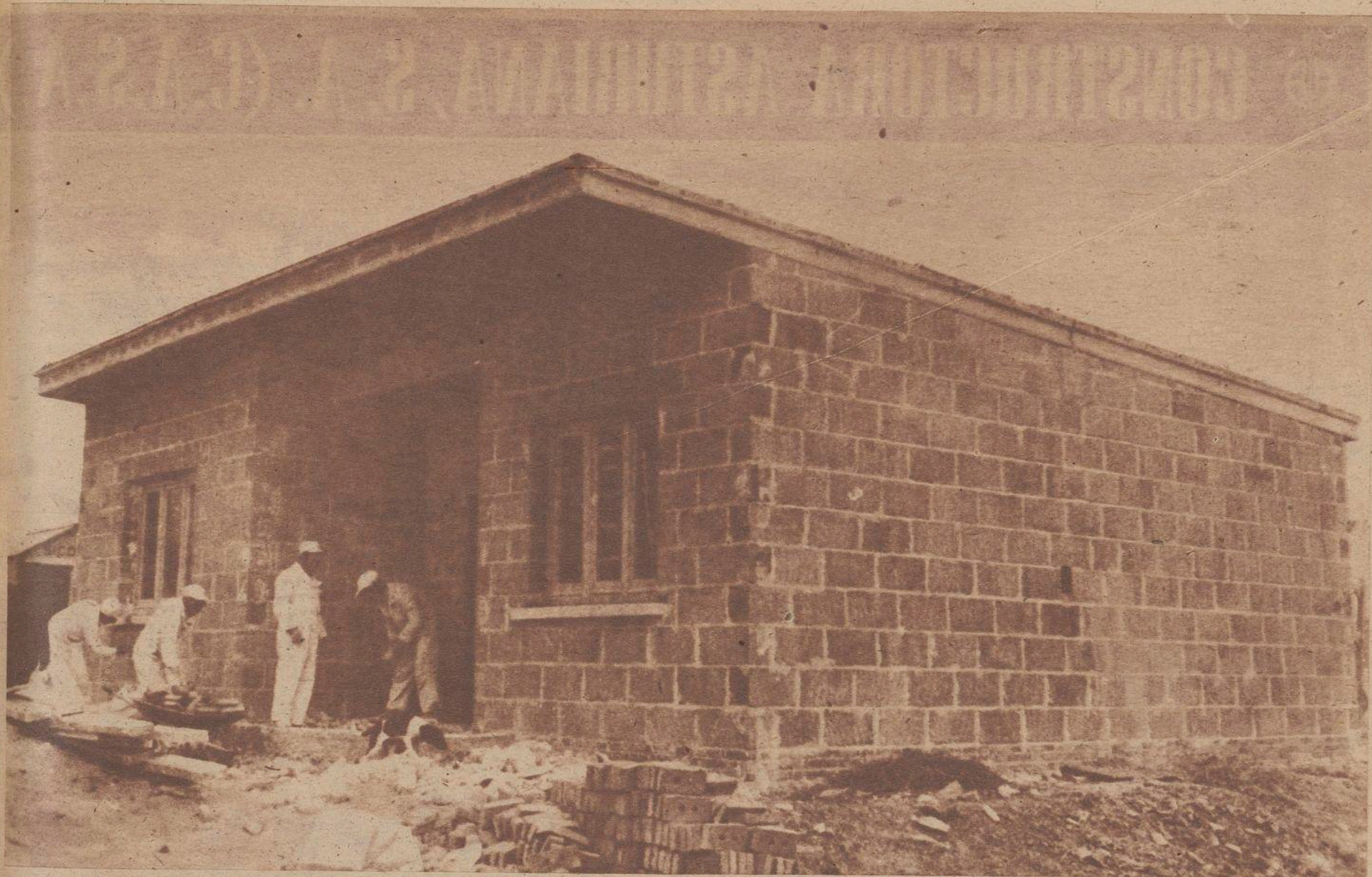
La vivienda experimental de Ytong, a los diez días de iniciar la obra.
